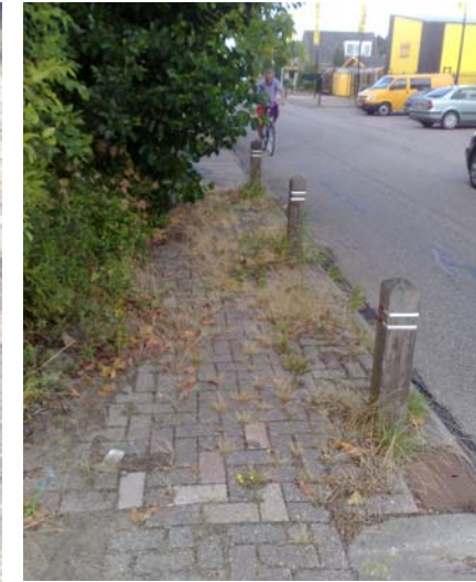
Onderhoud aan trottoir noodzakelijk
